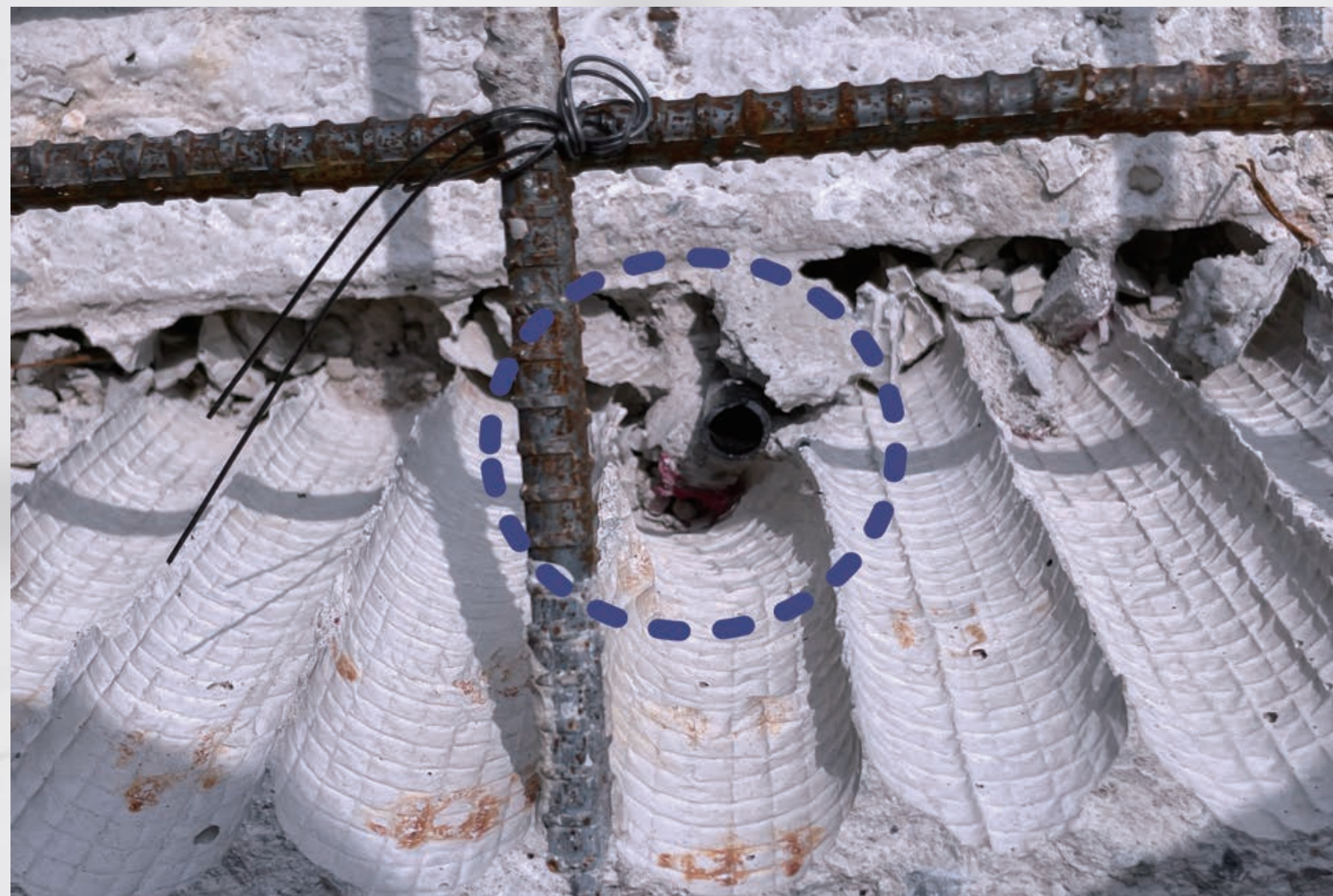
그림5. 거푸집 파손 예시
